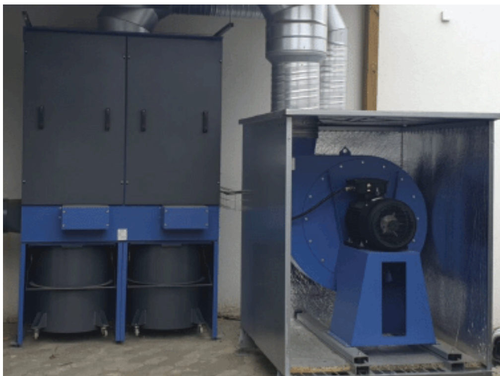
Foto: FRS/AUT 40 med 150L-støvbeholdere, værbeskyttelse for Roto-rens motorer og HV ventilator i VB lyddempingskabinett
